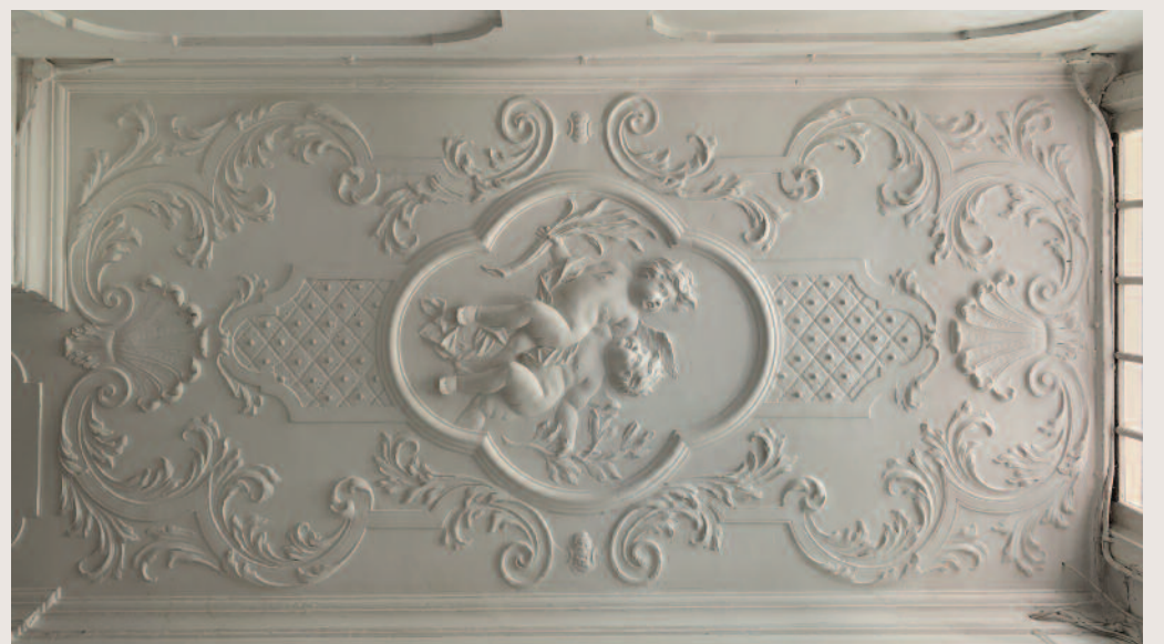
Amsterdam, Groenburgwal 56, stucwerk in de gang
